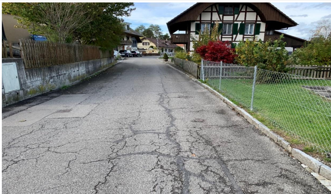
Abbildung: Belagsschäden durch Risse
