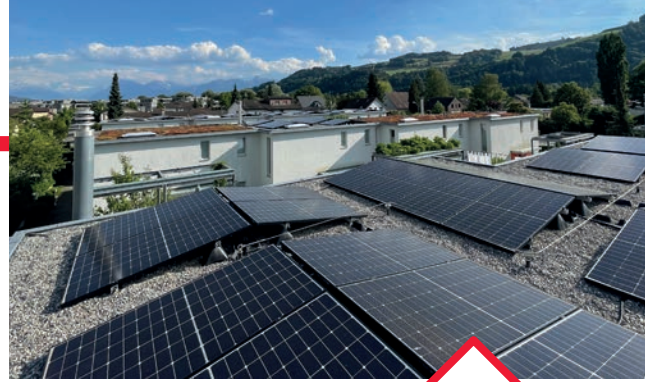
Im Mosermatte-Quartier erzeugen acht neue Photovoltaikanlagen Strom.
