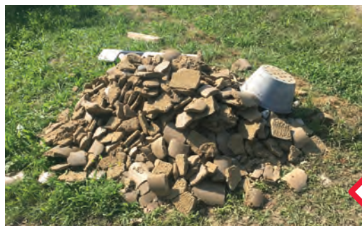
Entfernte Kalkablagerungen aus einer ca. 190 m langen Sauberabwasserleitung
