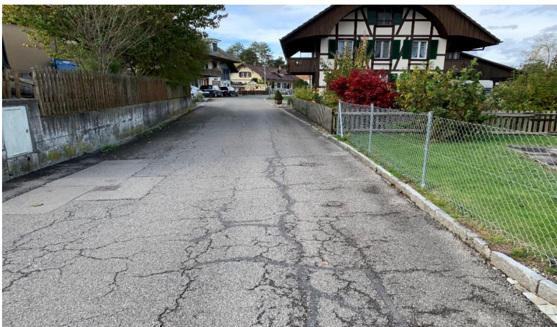
Abbildung: Belagsschäden durch Risse
