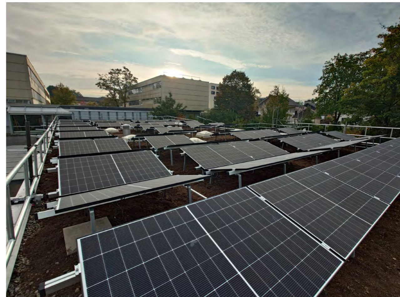
Die Solaranlage Kindergarten Schlossmatt ist seit Herbst 2025 in Betrieb.
