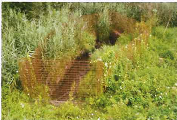
Abb. 9: Der Durchlass unter dem Bahndamm am Furtbach ist mit einer grossen Installation bibersicher vergittert worden.
