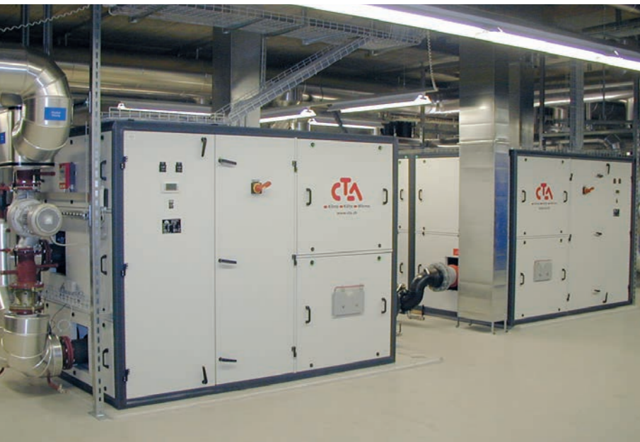
Energiezentrale Nord mit zwei Wärmepumpen
