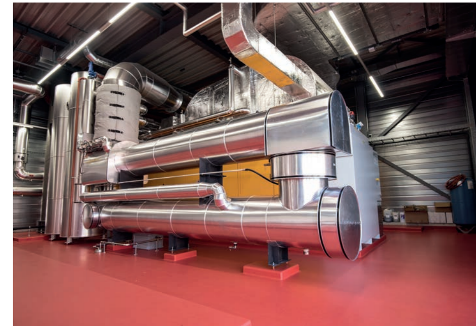
Energiezentrale Süd mit Blockheizkraftwerk (BHKW)
