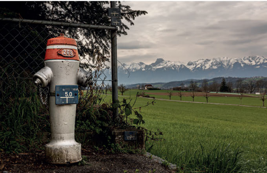
Hydrant 268, Finkenweg 1 ©Falk Tschirschnitz
