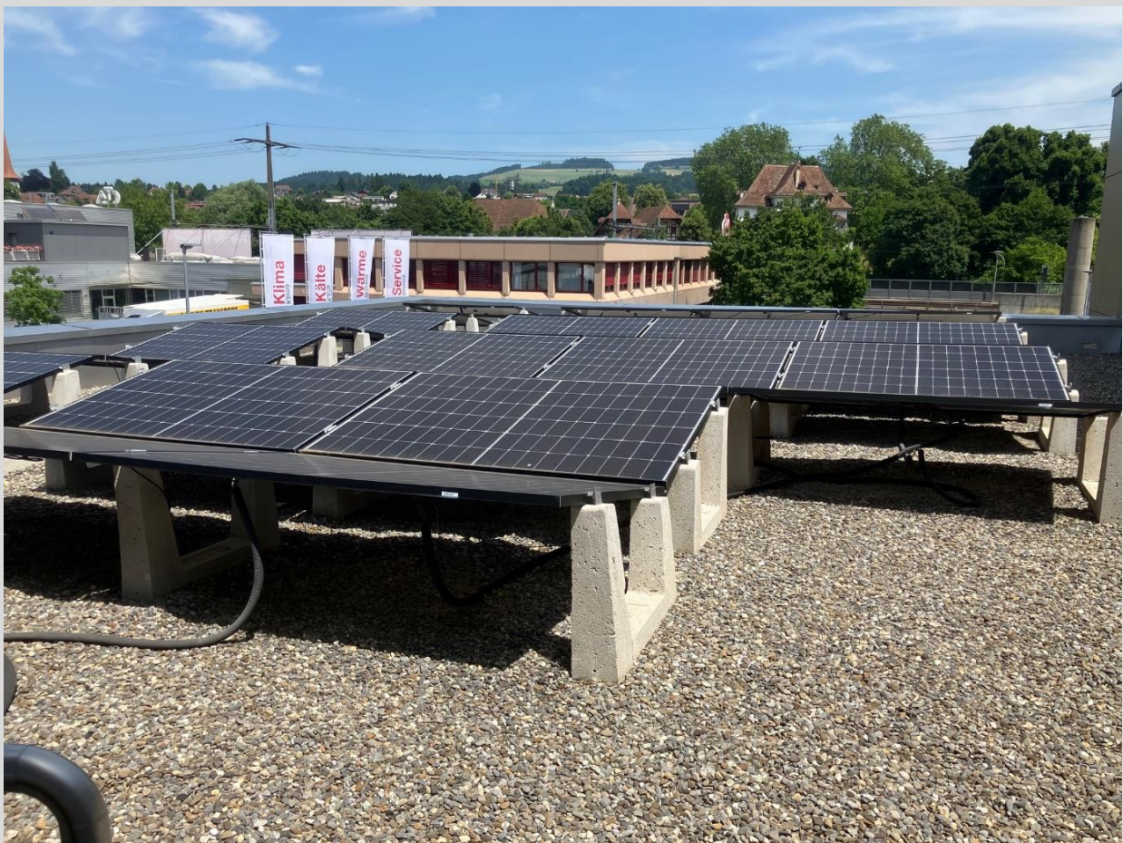
PVA auf dem unteren Flachdach
