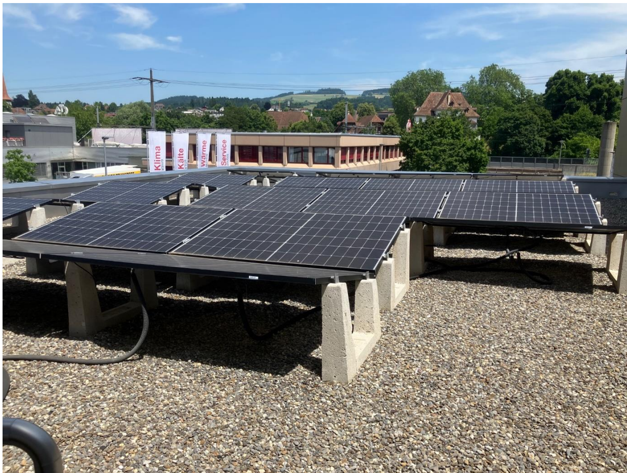
PVA auf dem unteren Flachdach
